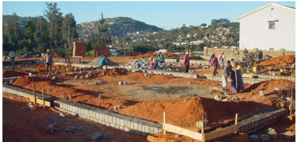
...Mitte Juli wachsen schon die Gebäude: „Es ist eindrucklich, wie über 100 Menschen ohne grössere Maschinen ganze Massen verschieben!“, schreibt Stefan Eichenberger.
